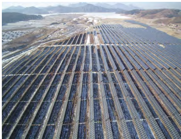
无人机拍摄光伏列阵区
