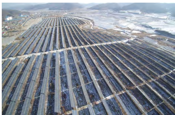
无人机拍摄光伏列阵区
