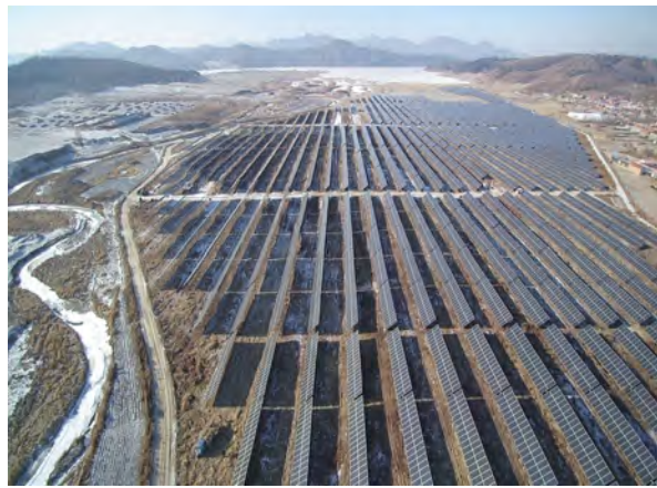
无人机拍摄光伏列阵区
