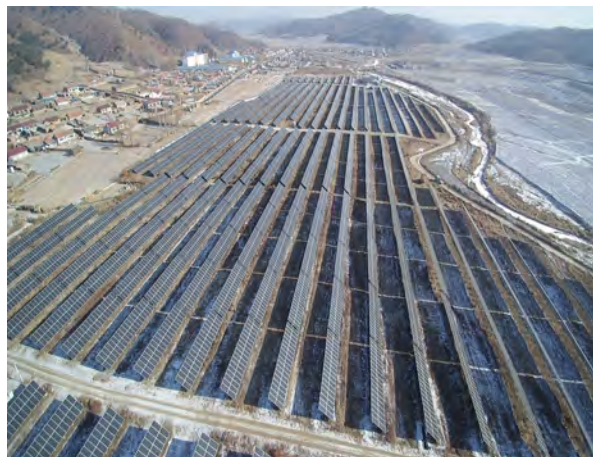
无人机拍摄光伏列阵区
